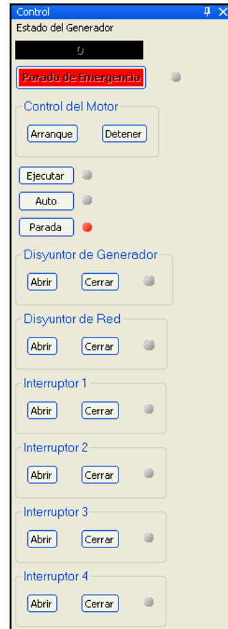
Figura 3-35. Pantalla Explorador de Medición, Control
