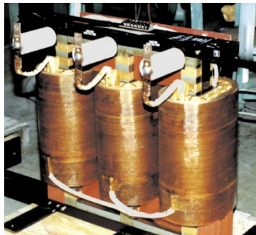
Figura 4 Transformador de Potencia (PPT)
