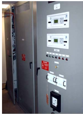
Figura 9 Gabinete con Sistema Redundante Digital de Control de Excitación
